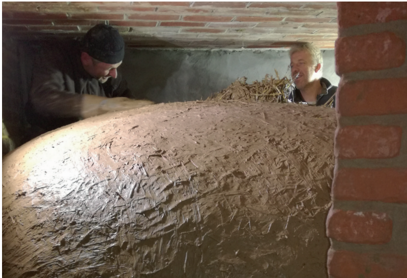
Foto: Nieuwe oven in hoekopstelling.
